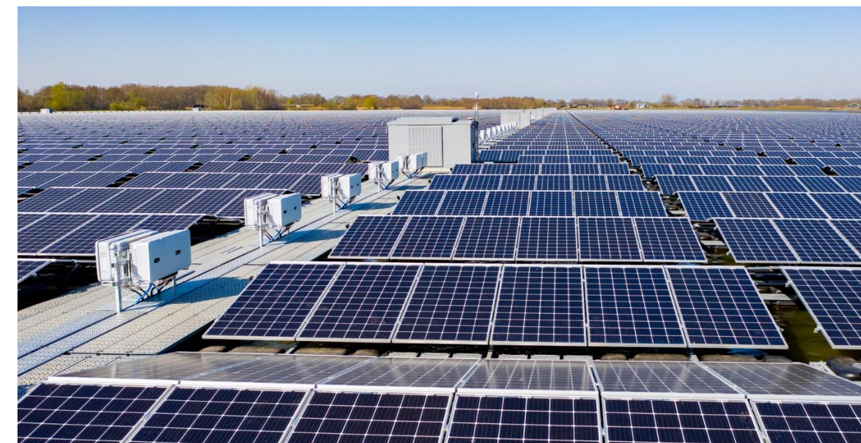
Figure 148 : Bloc solaire composé de rangées de bateaux solaires de part et d'autre d'une passerelle centrale abritant les onduleurs et le poste de transformation (source : BayWa r.e.)
