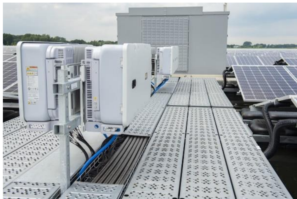
Figure 153 : Onduleurs reliant les lignes de bateaux solaires (source : BayWa r.e.)
