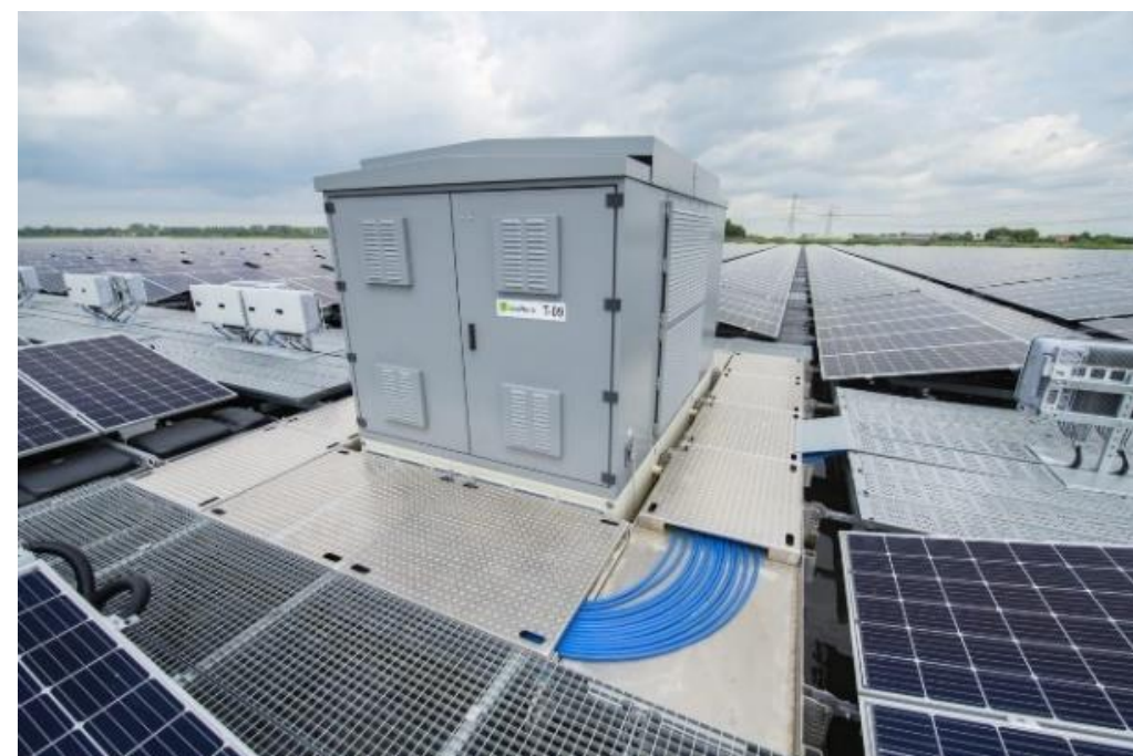
Figure 154 : Poste de transformation sur structure flottante (source : BayWa r.e.)
