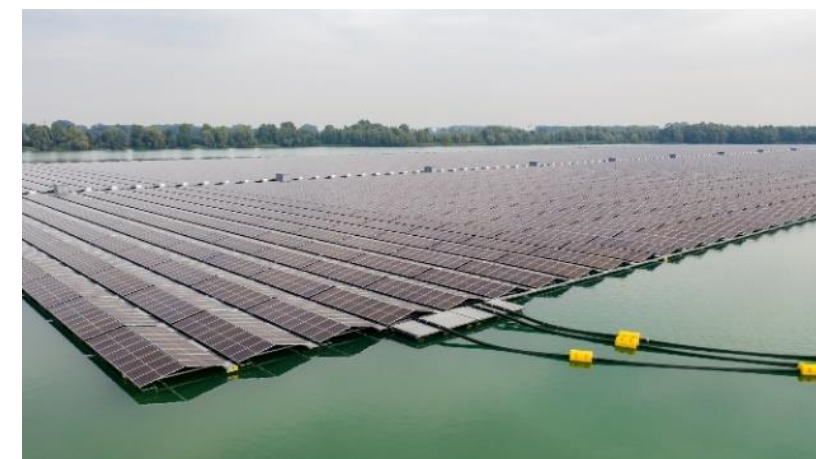
Figure 157 : Raccordement des postes de transformation aux berges grâce à des câbles flottants (source : BayWa r.e.)
