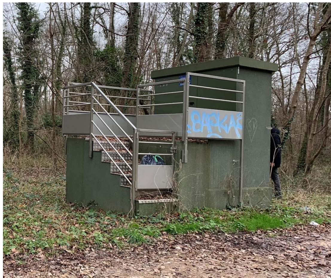
Figure 155 : Poste de livraison surélevé géré par Lafarge dans le cadre de l'exploitation de la carrière de Nançay et implanté à proximité du projet de parc photovoltaïque flottant de Dordives (source : BayWa r.e.)
