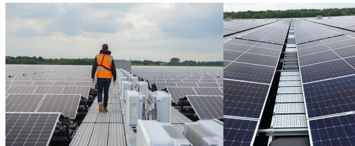
Figure 159 : Passerelles principales (à gauche) et secondaires (à droite) intégrées aux blocs solaires (source : BayWa r.e.)
