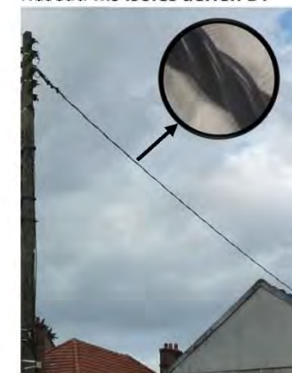
Réseau fils isolés aérien BT
