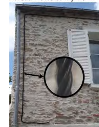
Réseau fils isolés façade BT
