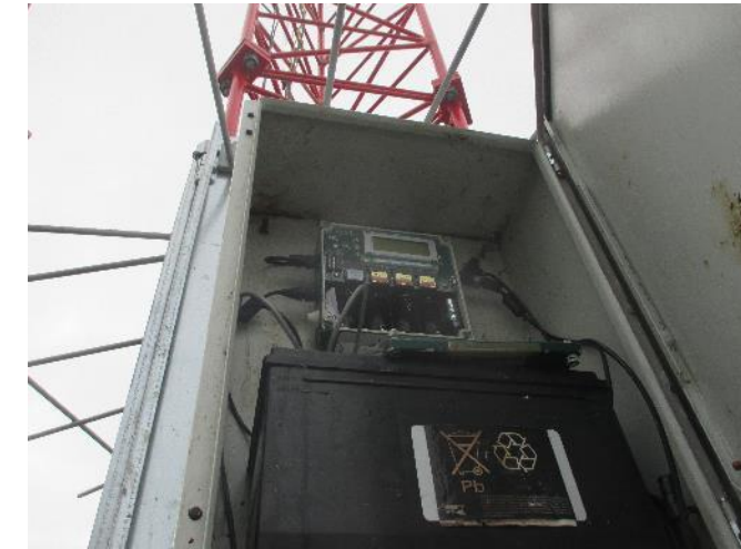
Photo 2 : SM4BAT et sa batterie installés dans un caisson de protection en bas du mât de mesure (Ecosphère)
