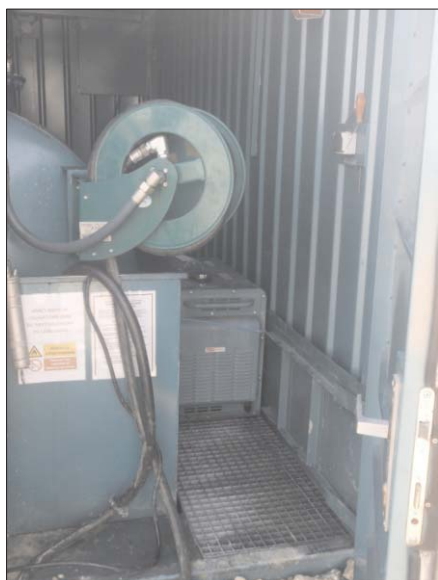
Cuve de carburant et pompe de distribution dédiées aux sous-traitants
