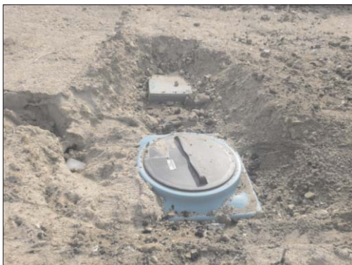
Débourbeur/déshuileur relié à l'aire étanche dédiée aux sous-traitants
