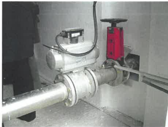
Vanne automatique complétée par une vanne manuelle. Source : Bio-Nrj.
