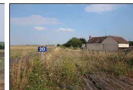
Voie ferrée dégradée Source : L'Artifex 2018
