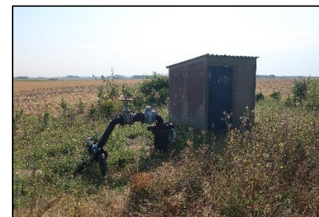
Captage sur la ZIP Source : L'Artifex 2018
