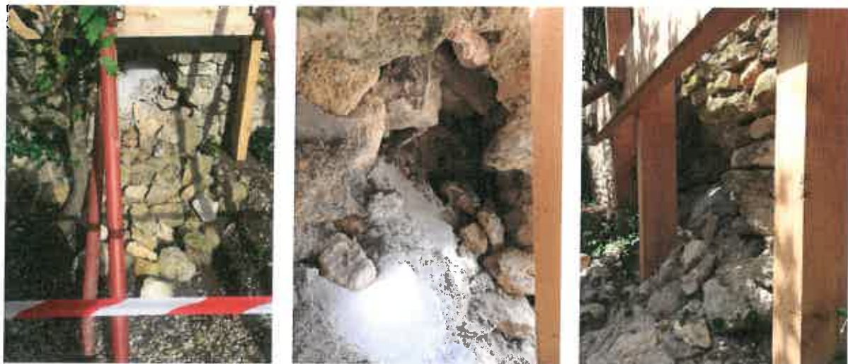
Effondrement du mur en partie basse
