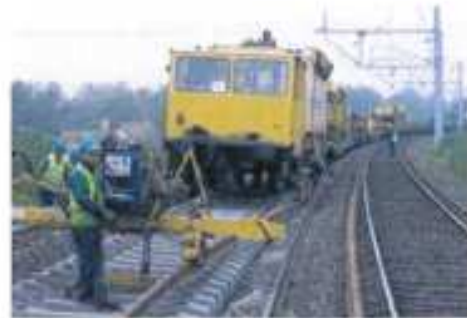
Longs Rails soudés sur traverses béton
