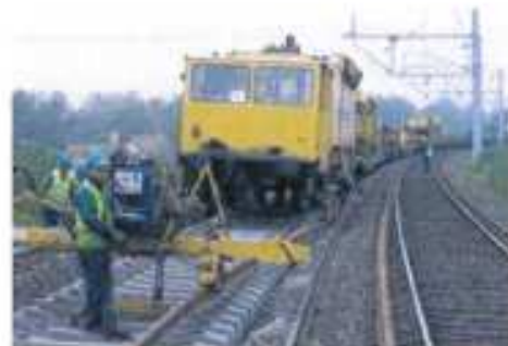
Longs Rails soudés sur traverses béton
