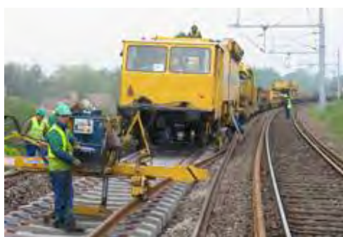
Longs Rails soudés sur traverses béton
