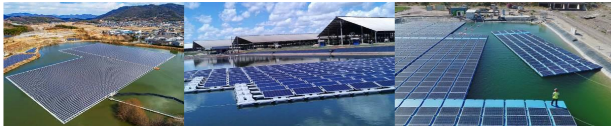
Figure 11 : Exemples de centrales photovoltaïques flottantes (Source : TotalEnergies)
