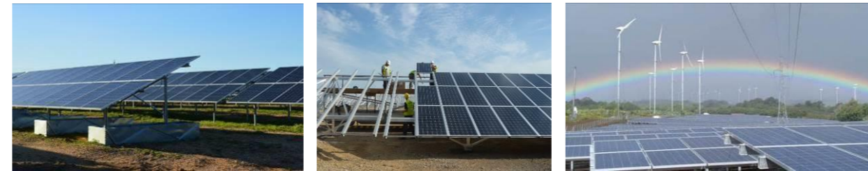
Figure 8 : Exemples de parcs photovoltaïques au sol (Source : TotalEnergies)
