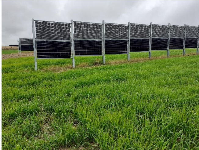
Figure 16: Centrale de panneaux verticaux (source : TotalEnergies)
