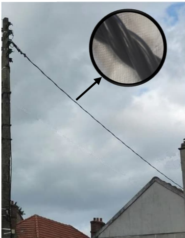
Réseau fils isolés aérien BT
