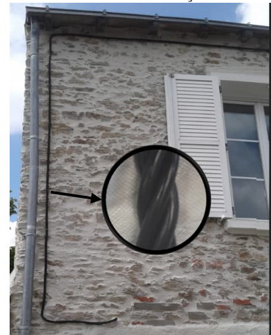
Réseau fils isolés façade BT
