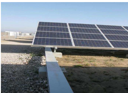
Figure 23 : Exemple d'un chemin de câbles (Source : ENGIE Green)
