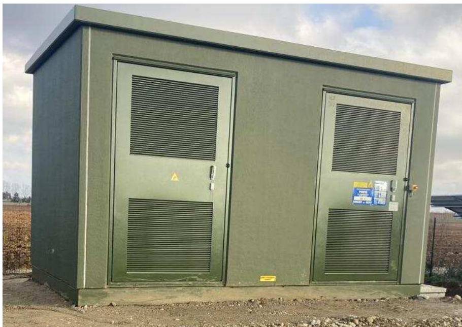
Figure 21 : Exemple de poste de transformation (Source : ENGIE Green)
