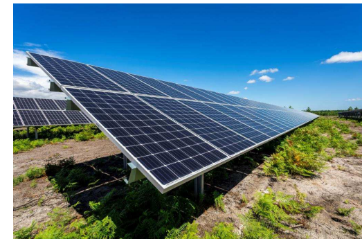
Figure 17 : Exemple de centrale photovoltaïque équipée de panneaux fixes (Source : ENGIE Green)
