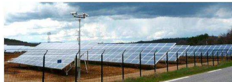
Figure 27 : Exemple de clôture et système de surveillance par caméras (Source : ENGIE Green)
