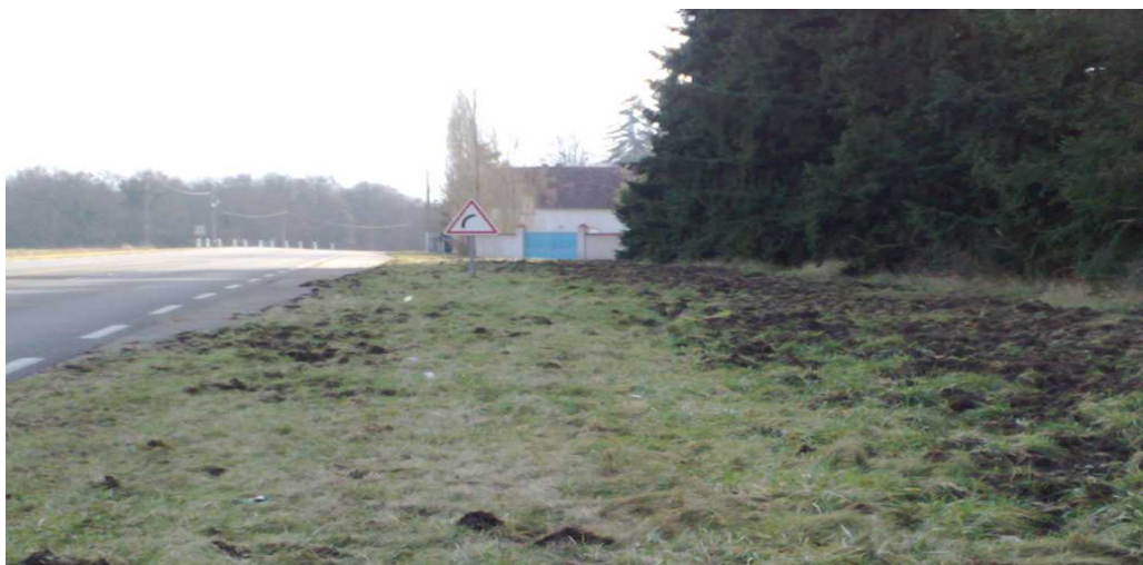
Dégradation de l'accotement de la nationale 7 par des sangliers (2011)
